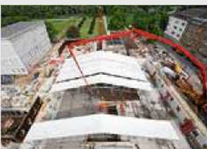
Échafaudage de protection
