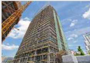
Échafaudage de façade
